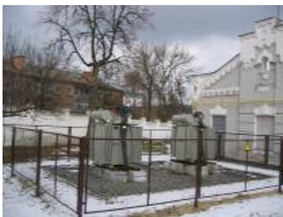
Рис. 1. Место установки трансформаторов.
