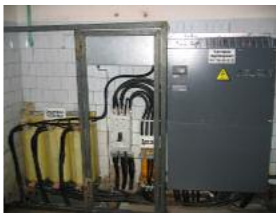
Рис. 2. Компоненты низковольтной части преобразователя частоты без ограждения
